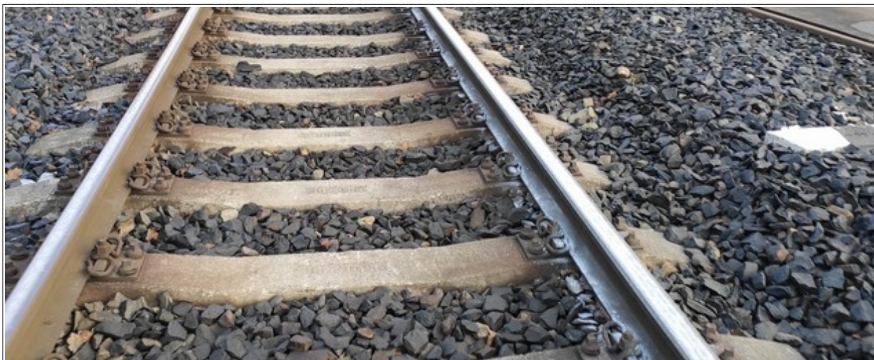
Obr. č. 2: Kolej s vrstvou písku mezi návěstidlem L6 a výhybkou č. 14 po vzniku MU
