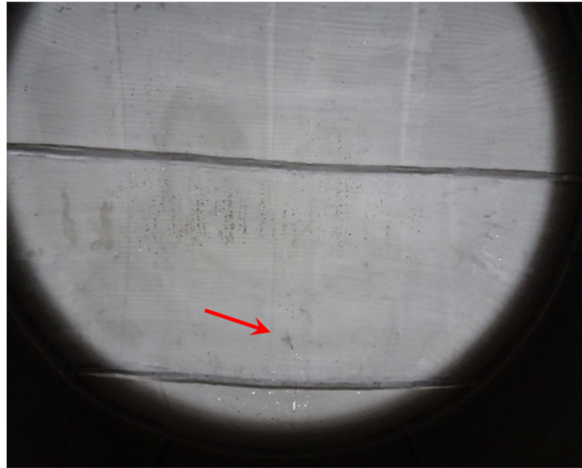
Abbildung 11: Bruchstelle im Tankinnern (roter Pfeil).
