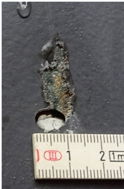
Abbildung 9: Detailaufnahme der Leckage.
