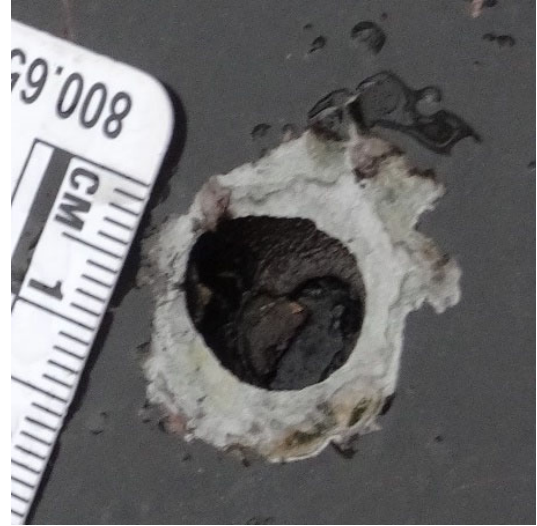
Abbildung 15: Ausprägung der Leckage im Stahlmantel.
