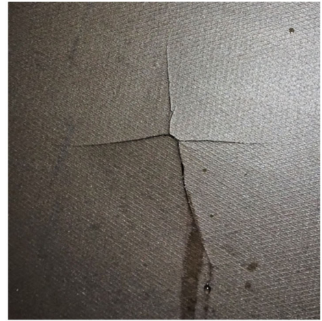
Abbildung 12: Detailaufnahme der kreuzförmigen Bruchstelle in der Schutzauskleidung.
