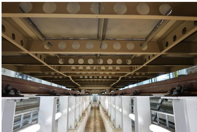
Figur 13: Oversiktsbilde av deformasjonen av rammeverket på vogn 228. Foto: SHK
