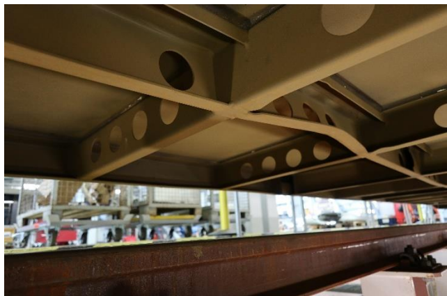
Figur 12: Deformasjon av rammeverk på vogn 228. Foto: SHK
