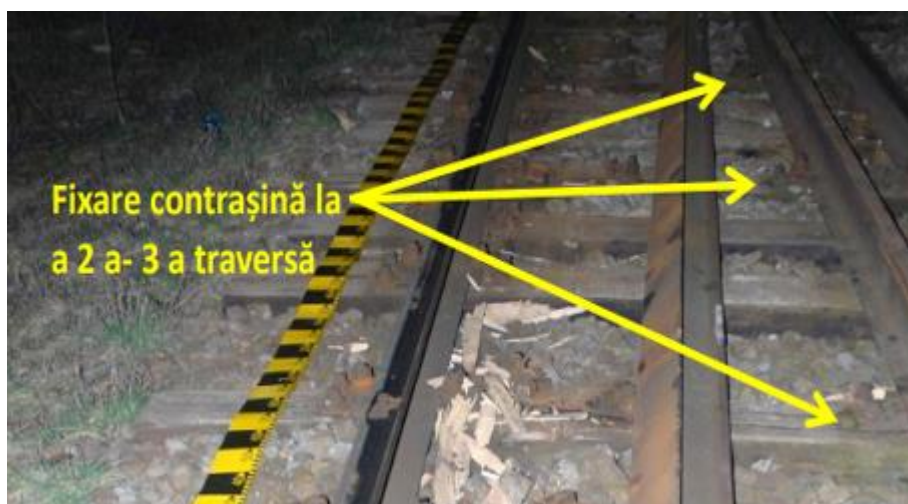
Foto nr.21 - Contrașină fixată numai la fiecare a doua – treia traversă
