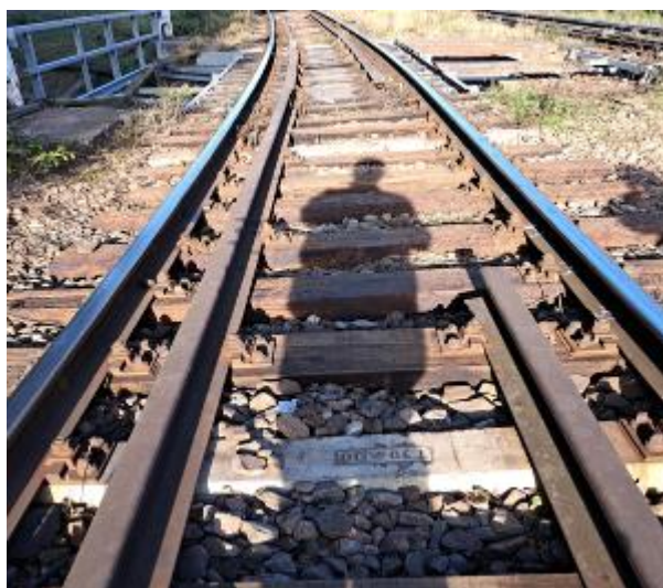
Foto nr.30 – lipsă continuitate la contrașină
