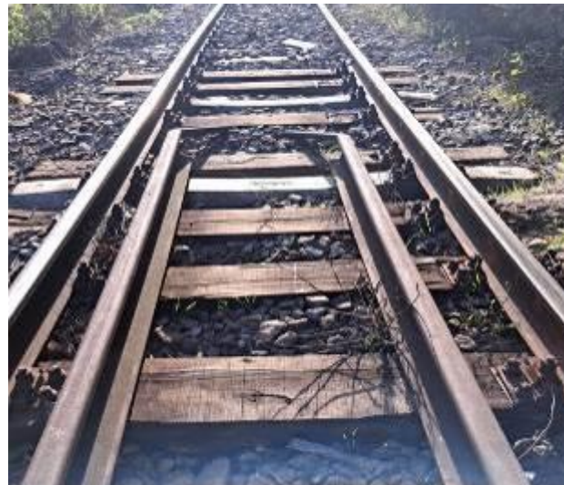
Foto nr.31 – lipsă prindere pe fiecare traversă
