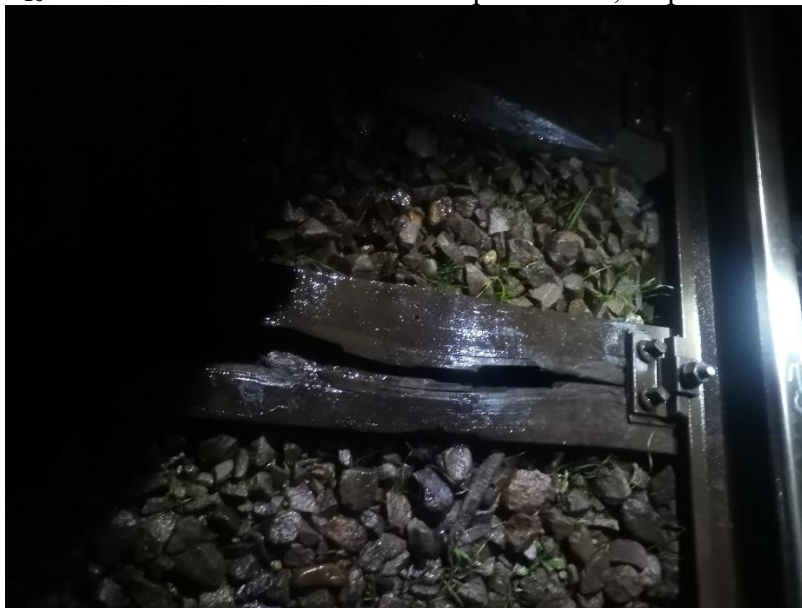
Foto nr. 12- Starea tehnică a traversei T-29
