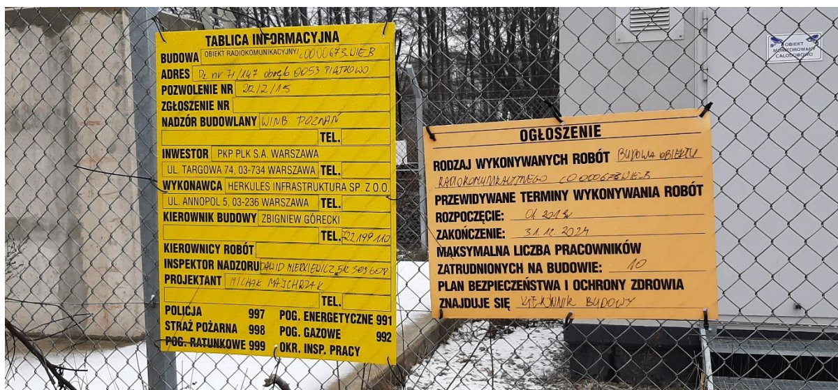
Zdjęcie 8 – Tablice umieszczone na ogrodzeniu obiektu budowlanego
