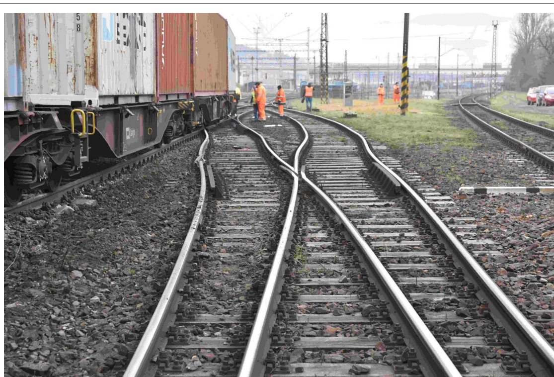
Obr. č. 12: Pohled na poškození výchybky č. 49
