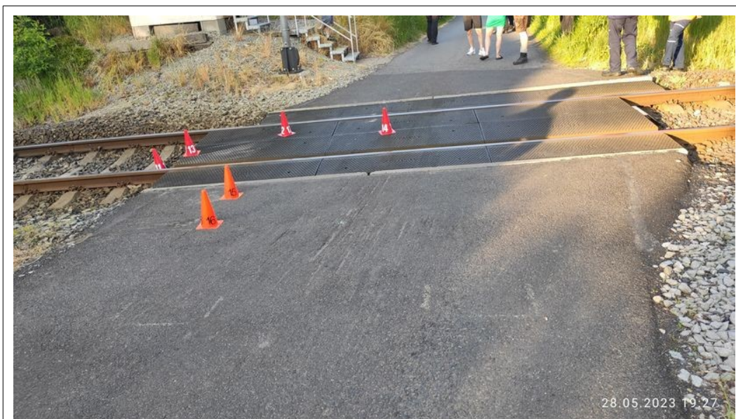
Obr. č. 15: Pohled na ŽP P3277 směrem od Dymníku a rýhy na horní části vozovky
