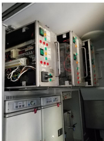
Figura 82: Imagem dos equipamentos soltos na zona do bar do CPA 4005
