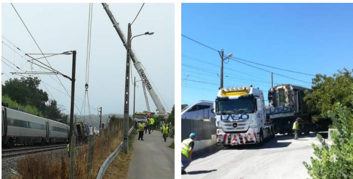
Figura 35: Operações da emergência ferroviária – desimpedimento das vias
