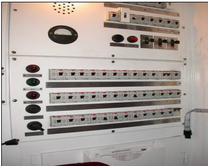
Figur 20: Bilde av sikringspanel.
