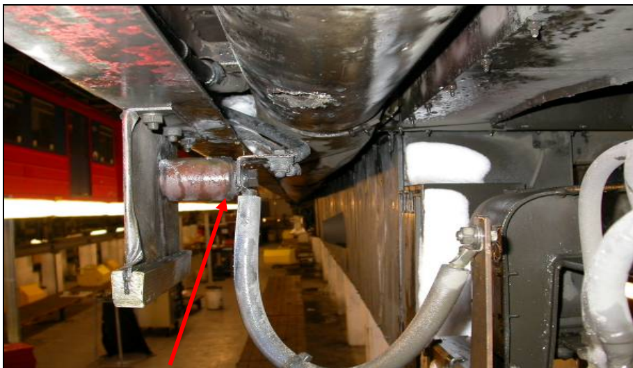
Figur 17: Bilde av kabel og isolator ved strøminntak.
