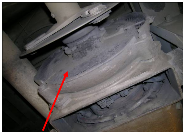
Figur 14: Bilde av motor med tett luftinntak.
