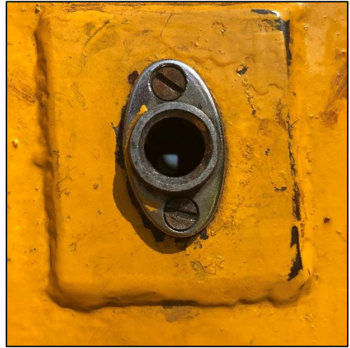
Figur 8: Manglende dørhåndtak. Foto: SHT
