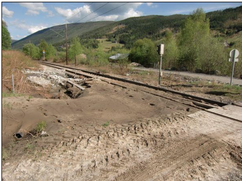
Figur 6: Flomskadene ved km 281,470. Foto: Jernbaneverket
