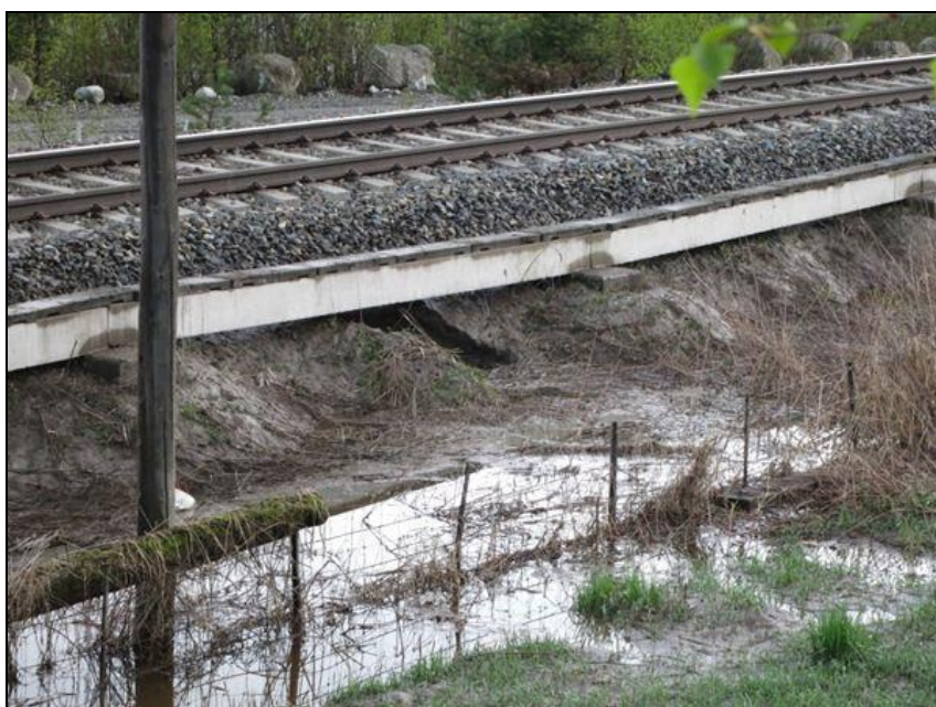
Figur 7: Tilstanden ved km. 281,507. Foto: Jernbaneverket
