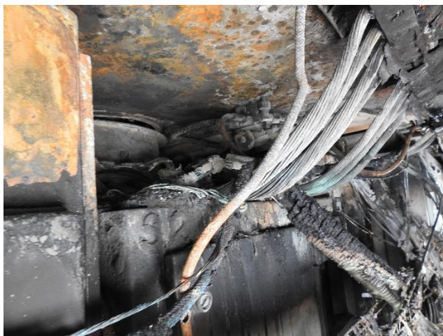
Figur 19: Brente kabler ved ventilasjonssjakt. Foto: SHK
