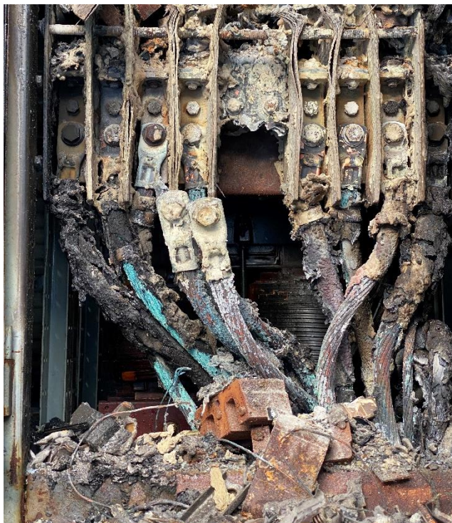
Figur 27: Avbrente koblinger S8-skap. Foto: SHK
