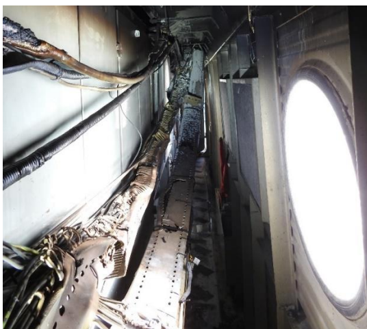
Figur 18: Brente kabler i maskinrom. Foto: SHK
