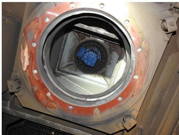
Figur 21: Innvendig i ventilatorsjakt. Foto: SHK
