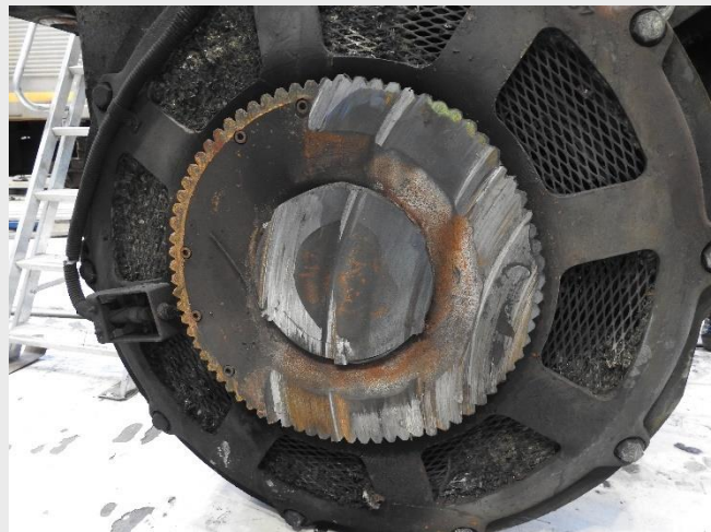
Figur 12: Tannhjul for hastighetsgiver. Foto: SHK
