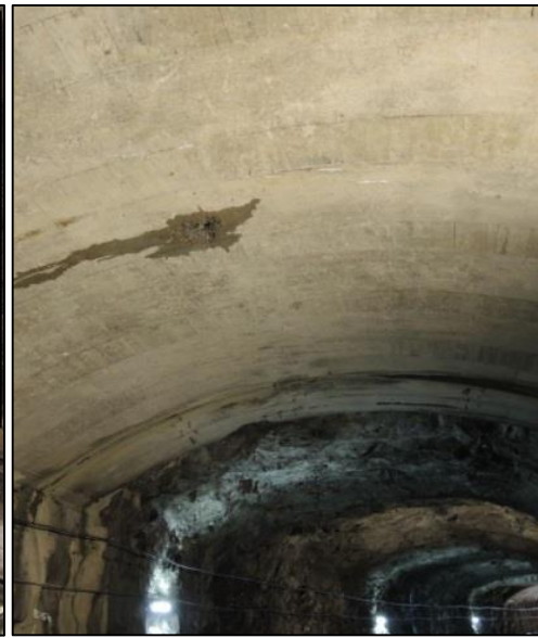
Figur 4: Hull i tunneltaket. Foto: SHT
