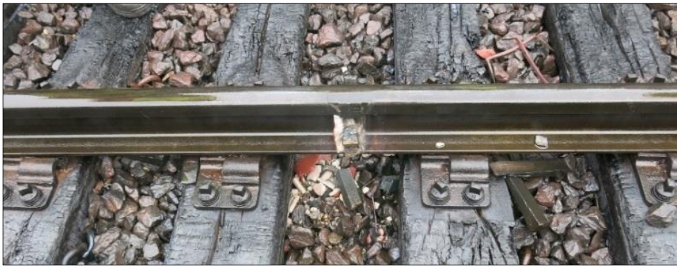
Figur 29: Grovslipt sveis ved km 39,403. Foto: SHT
