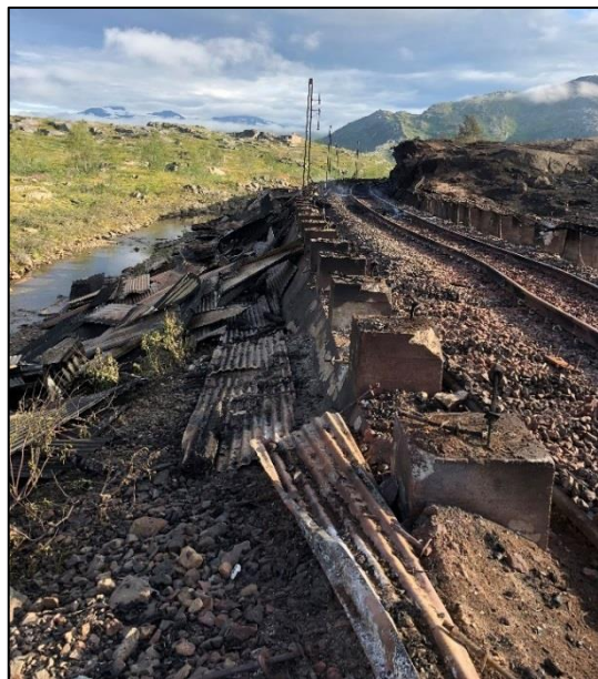
Figur 14: Skader etter brannen. Foto: Bane NOR SF
