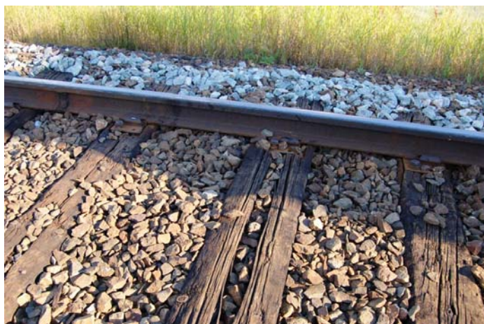
Figur 4: Tresvillene fra 1961 var generelt i dårlig forfatning.
