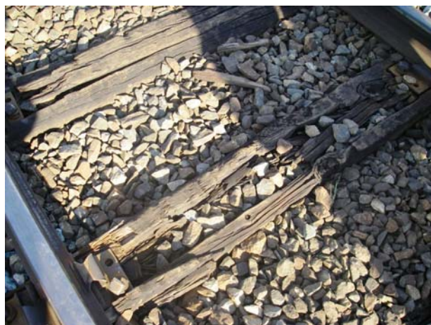
Figur 5: Flere tresviller i dårlig forfatning.
