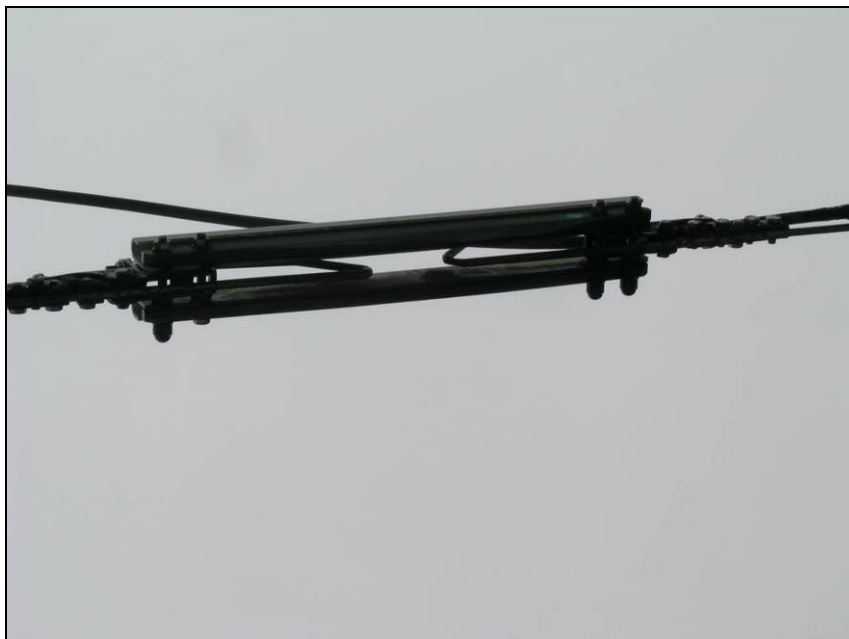
Figur 6: Bilde av seksjonsskille, tilsvarende det som kortsluttet og brant.
