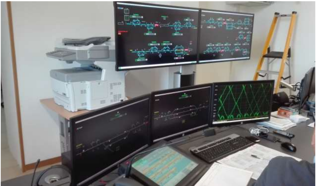
Figura 10 - Postazione 1 del DCO di Novoli
