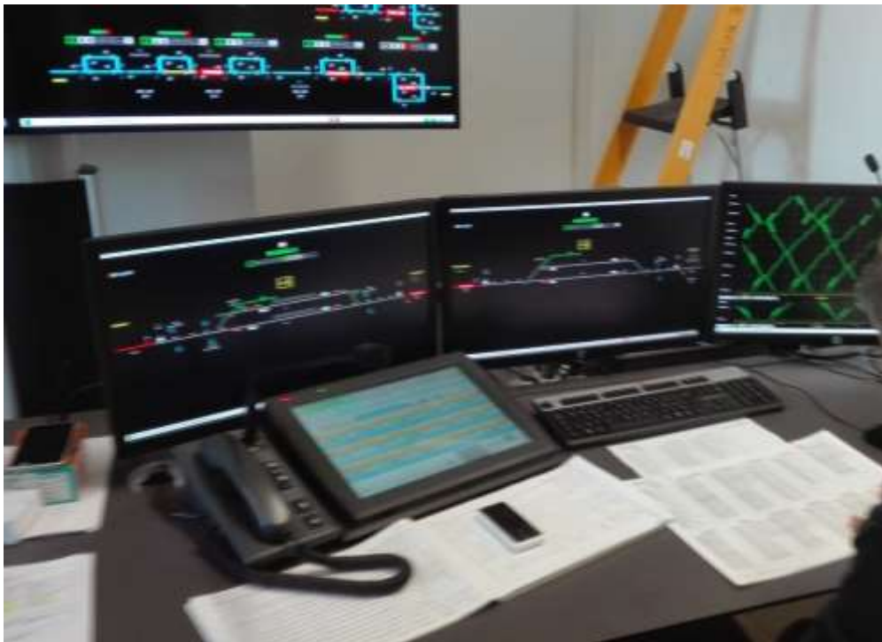
Figura 12 - Postazione 2 del DCO di Novoli
