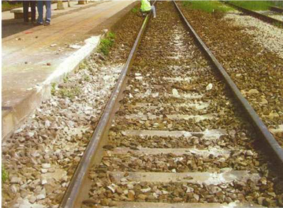
Punto dello svio e urto contro il marciapiede (vista sud – nord) – Fonte Commissione Ministeriale di Indagine
