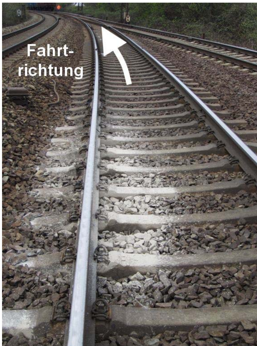
Abb. 7: Detailansicht Schlammstelle in ca. km 21,265
