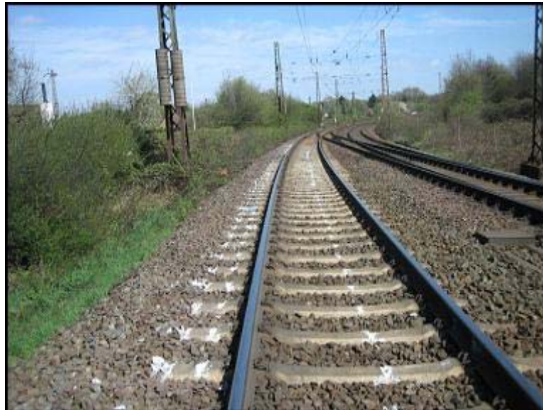
Abb. 24: beschädigte Betonschwellen hinter Weiche 2
