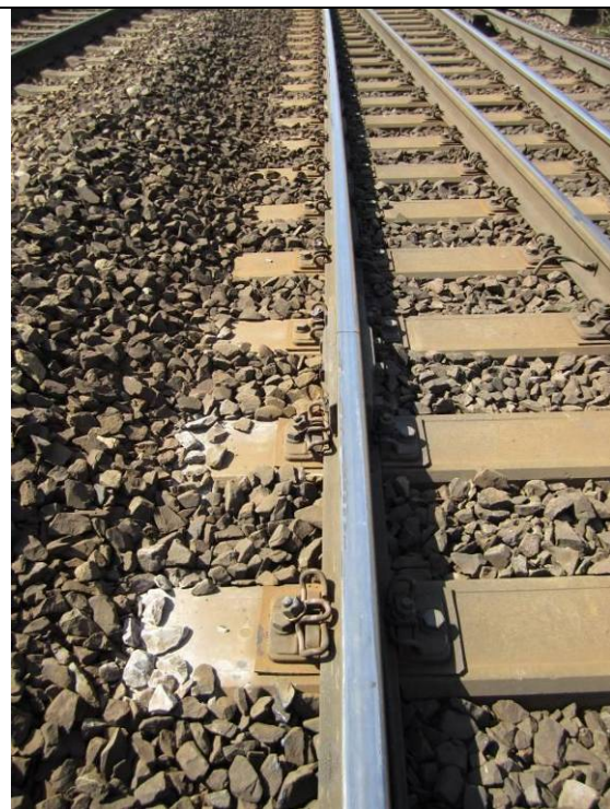
Abb. 18: Schäden vor W 3 linke Schiene
