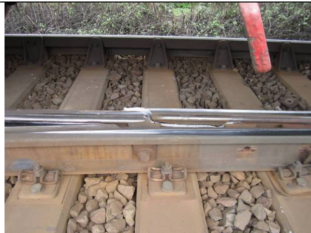
Abb. 22: gebrochene rechte Flügelschiene in W 2
