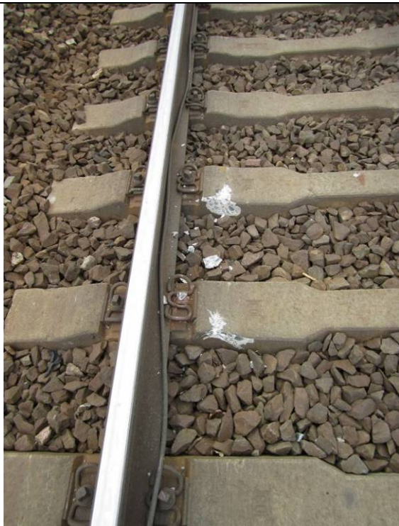
Abb. 16: Beschädigte Schwellen linke Schiene
