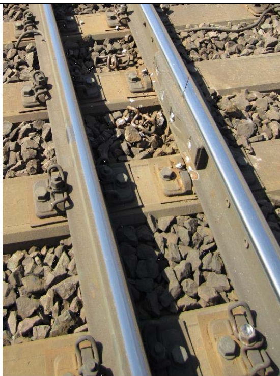
Abb. 19: Schäden in W 3 rechte Schiene
