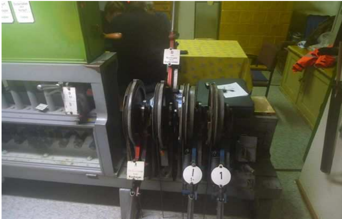
Bild 4: Stellwerk, Üst Hordorf
