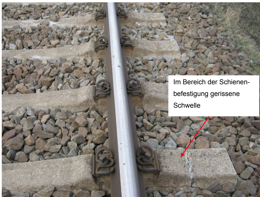
Abb. 8: Im Bereich der Schienenbefestigung gerissene Schwelle
