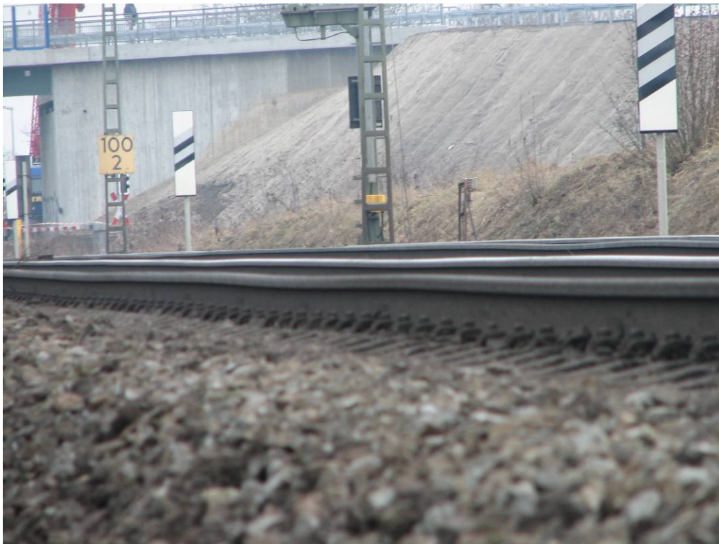
Abb. 5 Die Gleislagefehler sind ohne Hilfsmittel visuell erkennbar
