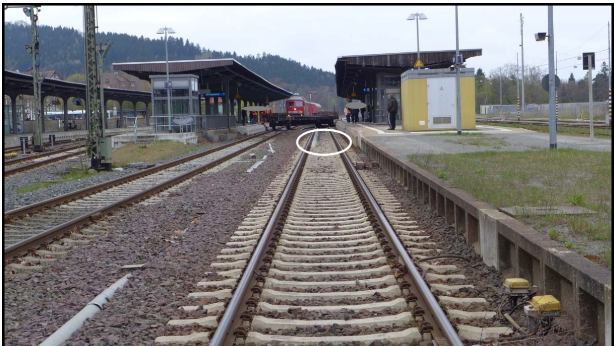
Abb. 7: Beginn der Entgleisungsspuren
