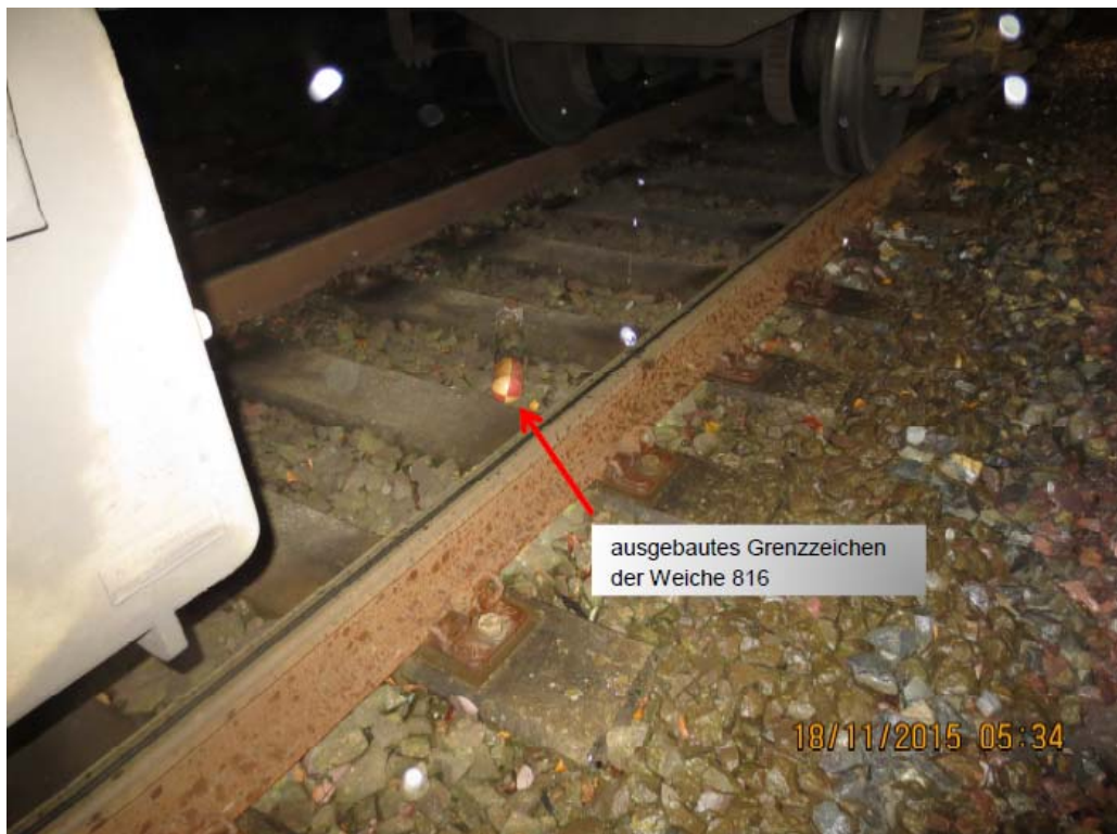
Abb. 6: Lage des So 12 der Weiche 816 im Gleis 802
