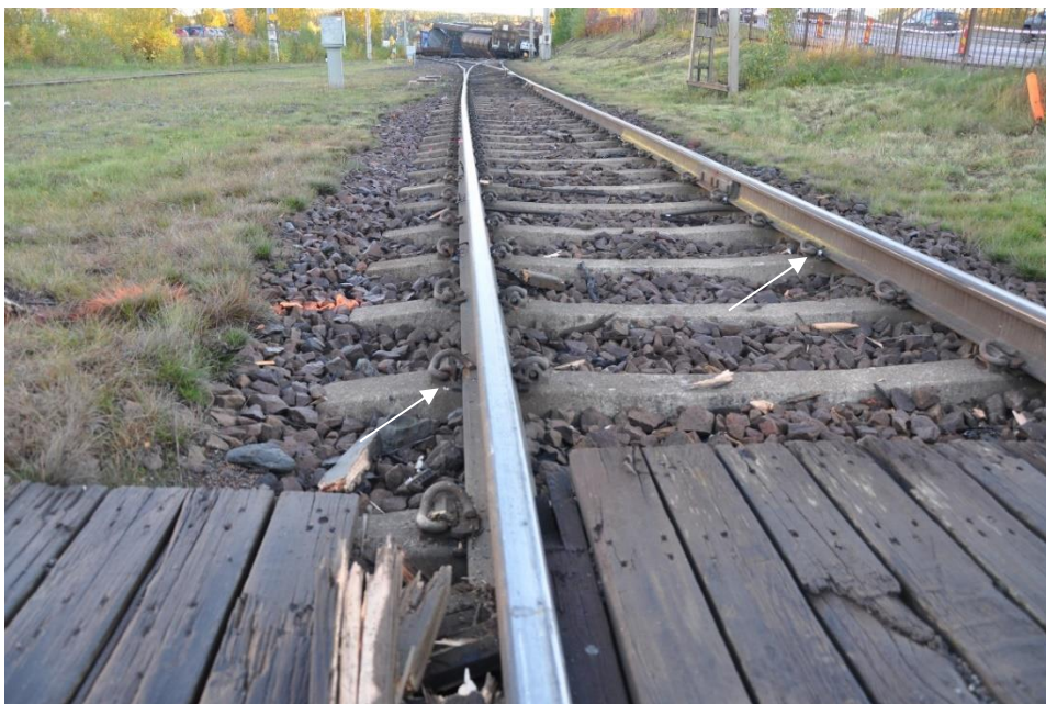
Figur 14. Bild mot växel 468. Exempel på skadade pandrolbefästningar utmed rälerna och på skadade mellanlägg.
