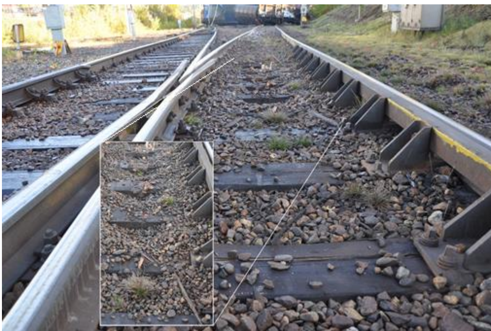
Figur 18. Skador på träslippers mellan korsning och moträl.
