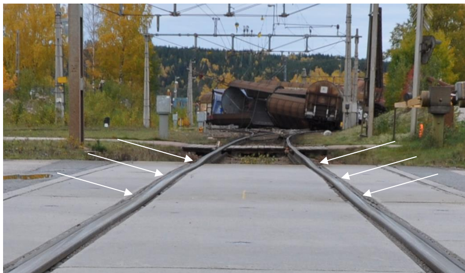
Figur 20. Lyviksvägens vägövergång med markeringar av höjdskillnader i spåret. (Notera att bilden togs efter händelsen när spåret var obelastat. Spårläget kan således ha varit annorlunda vid tiden för händelsen).
