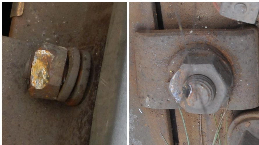
Figur 16. Specifika skador på bultförband i växel 468 med längsgående ränder (vid position 1 och 6 i figur 15).
