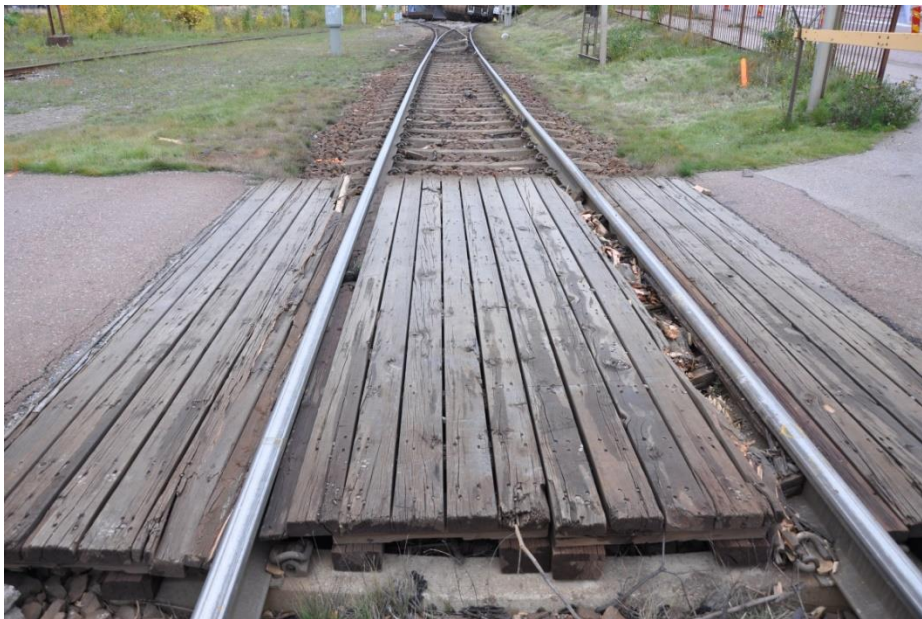
Figur 13. Bild mot olycksplatsen på de skadade plankorna i gång- och cykelvägen.
