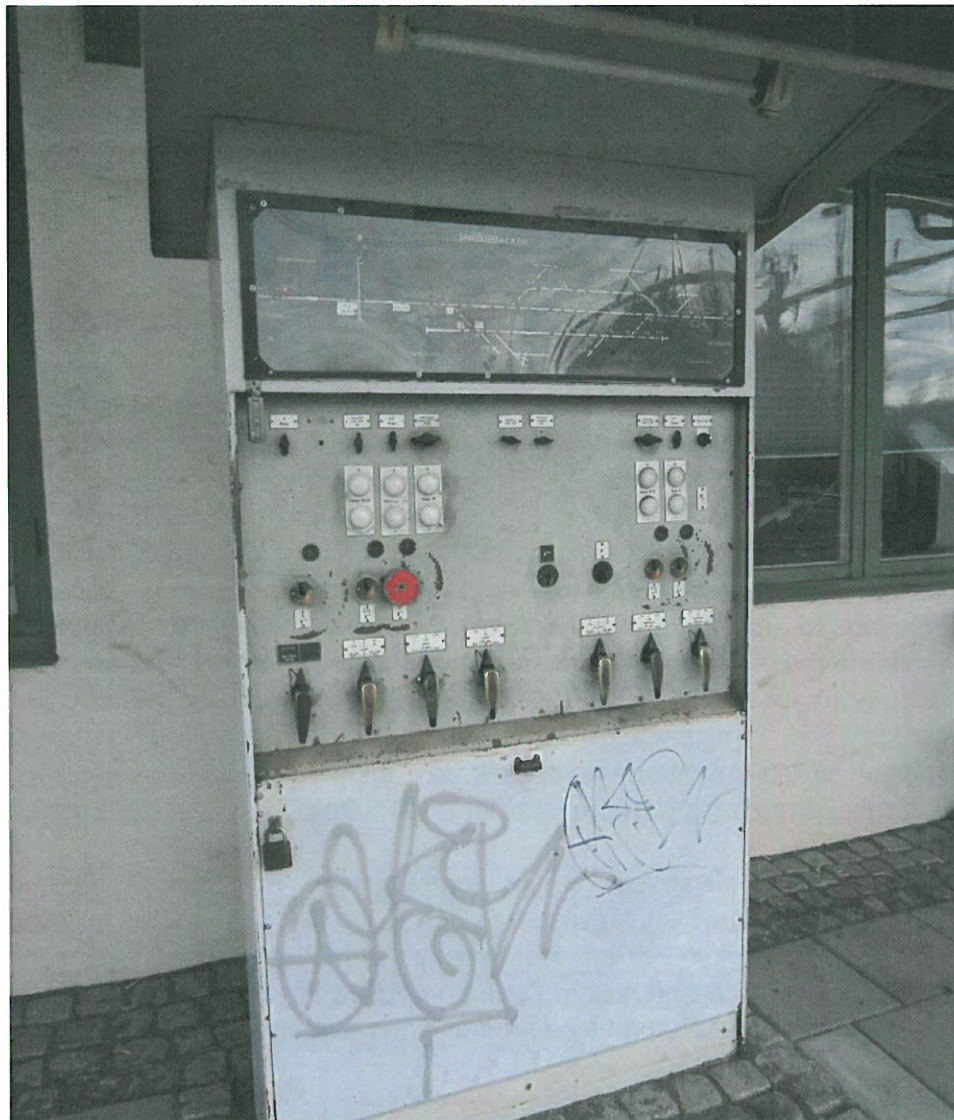
Figur 4. Signalställverket i Smedjebacken (Centralapparat).
