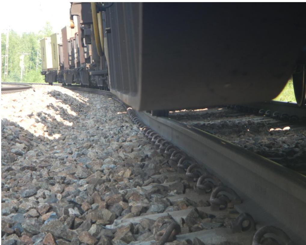
Figur 2. Utknäckning av spåret under ej urspårade vagnar.
