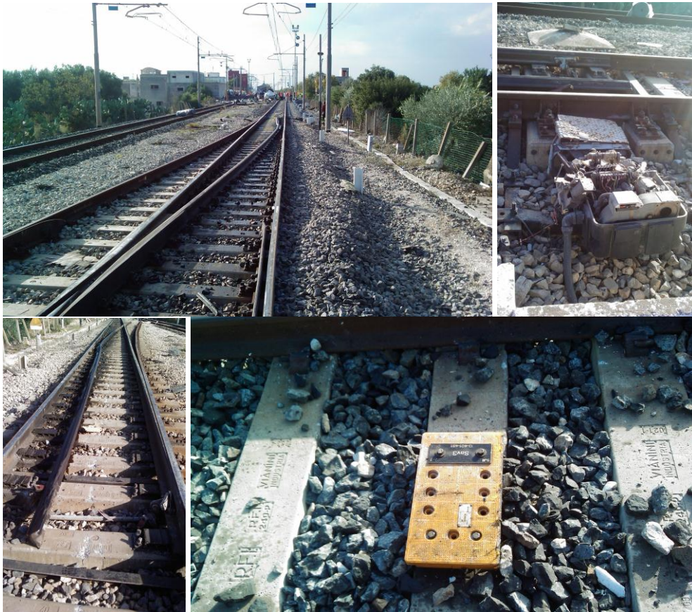
Figura 7: Foto dei danni riportati dall'infrastruttura
