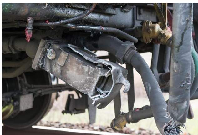
Figura 5: Dettaglio dei danni riportati dal treno 2655 (Fonte: Gazzetta di Mantova. Foto: Rizzo)
