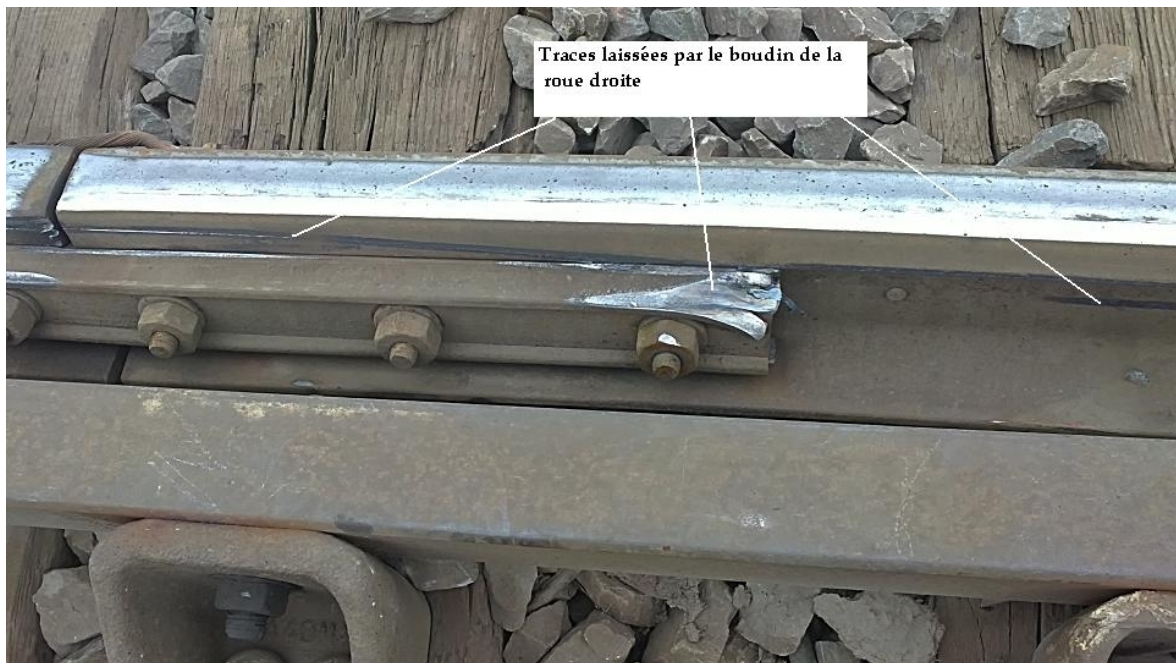
Illustration 18 : traces de déraillement au niveau du contre-rail
