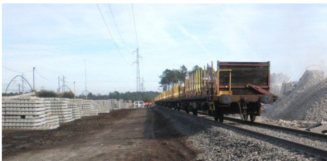
Figure 7 : zone de stockage des traverses et rame de wagons R09.5
