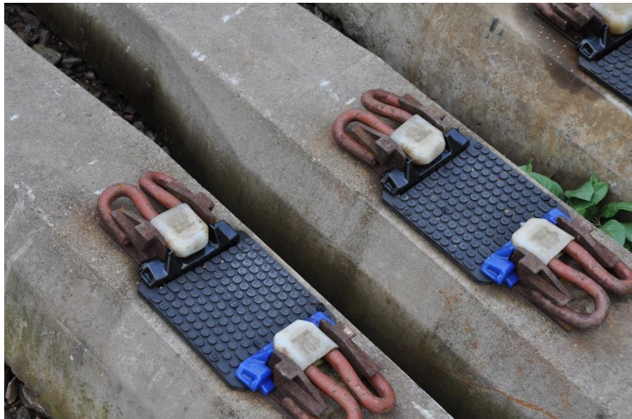
Figur 3. Sliprar med isoleringar och gummiplattor.
