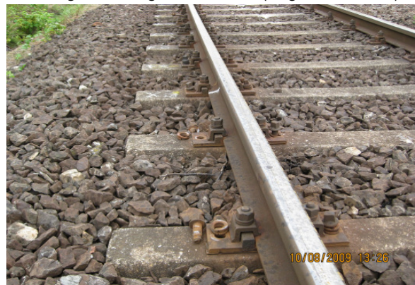
Detail gebrochene /lockere Schwellenschrauben
