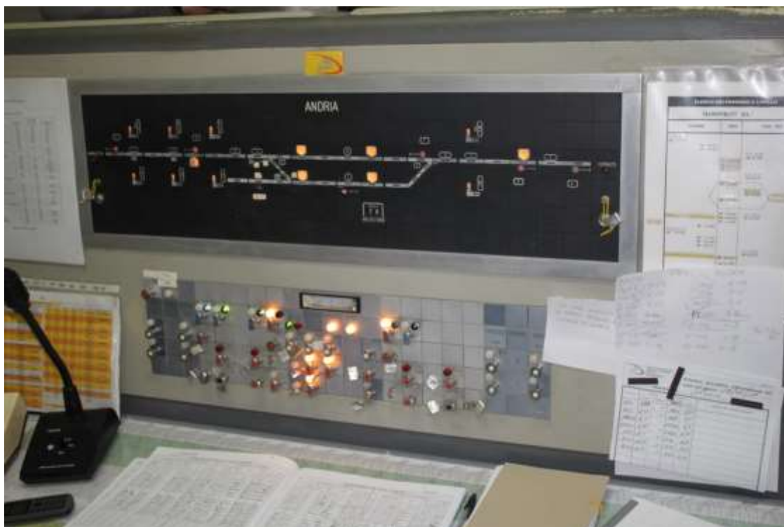
Figura 16 - Banco di manovra della stazione di Andria
