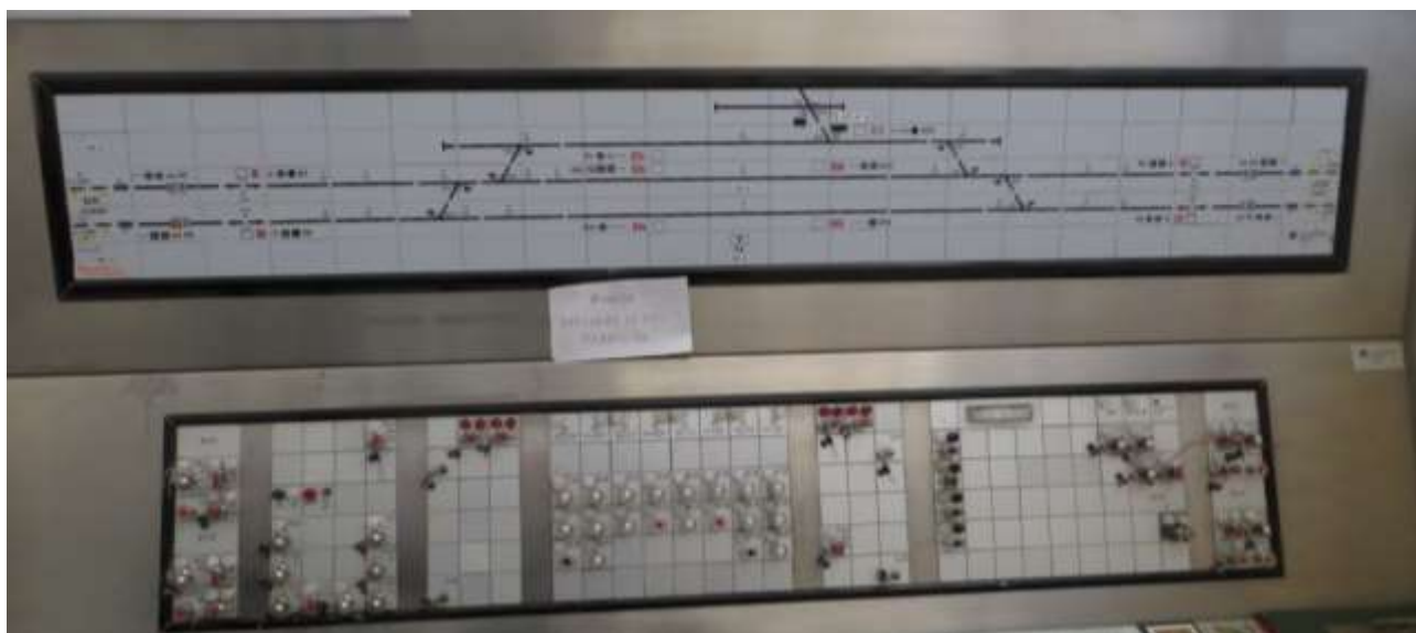
Figura 10 - Banco ACEI e Quadro Luminoso della Stazione di Squinzano
