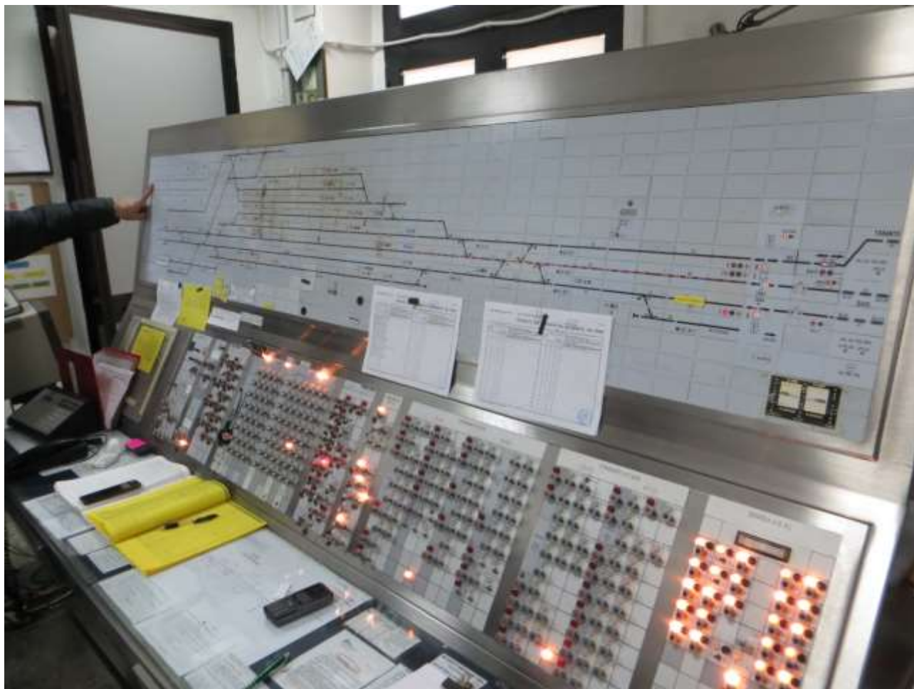
Figura 8 - Banco ACEI e Quadro Luminoso della Stazione di Brindisi
