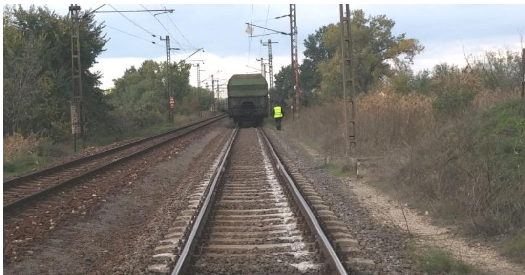
5. ábra: A kisiklott kocsi által megrongált vasbetonaljak.
