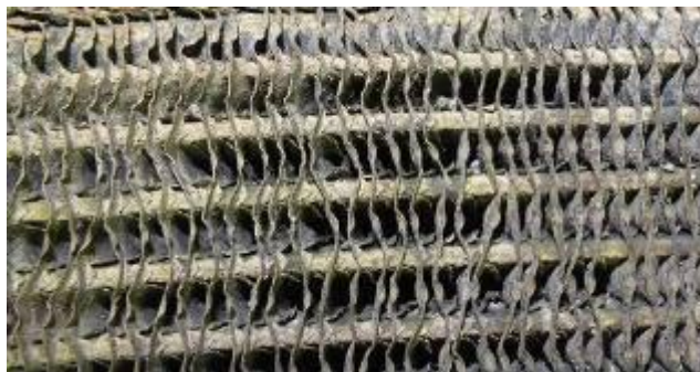
10. ábra: A megsérült olajhűtő-panel
