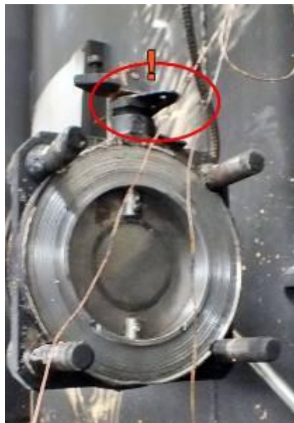
11. ábra: A megsérült főelzáró
