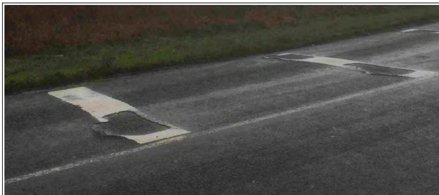
Figure 14 : exemples de détériorations de la chaussée (photo BEA-TT)
