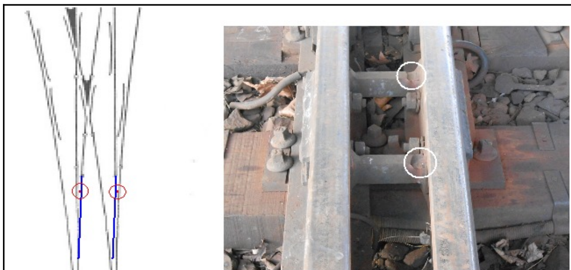
Figure 17 : Premières traces d'impact sur les entretoises de talon de l'aiguille 32
