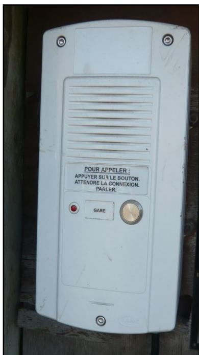
Figure 11 : Le téléphone du passage à niveau.
