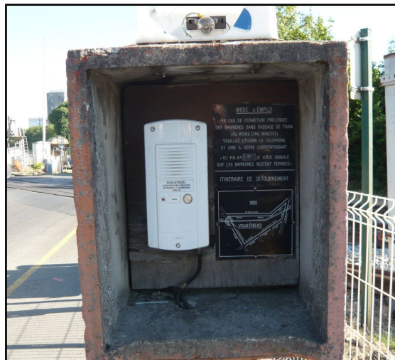
Figure 10 : Le coffret en béton contenant le téléphone du sens de circulation de l'ensemble routier accidenté. Vue depuis la RD409.
