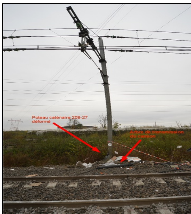
Figure 15 : État du poteau caténaire n° 209-27 après l'accident
