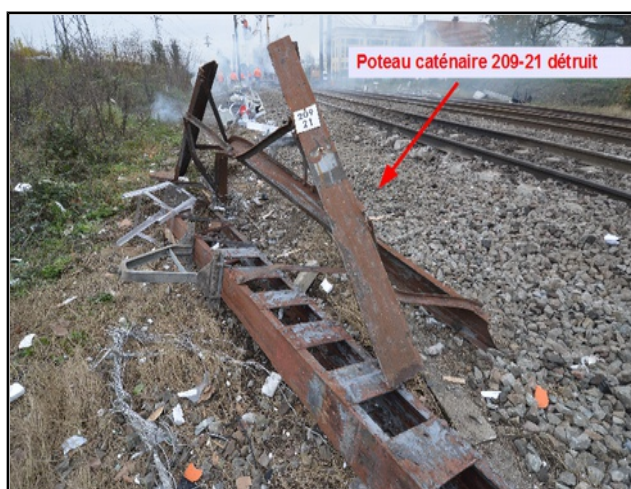
Figure 13 : État du poteau caténaire n° 209-21 après l'accident
