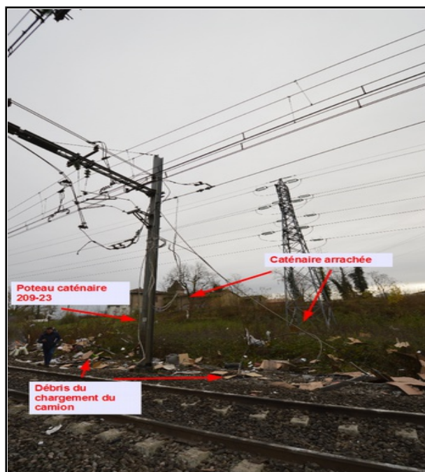
Figure 14 : État du poteau caténaire n° 209-23 après l'accident
