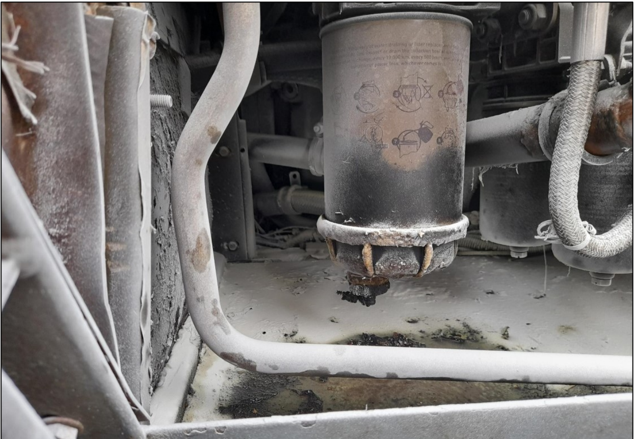
Kuva 22. Savonlinnassa 12.10.2021 palaneen yksikön 4406 sulanut polttoaineen suodatin. (Kuva: VR-Yhtymä Oy)
