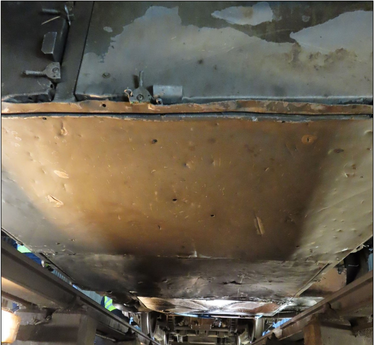
Kuva 11. Palaneen Dm12-kiskobussin kolhiintuneita moottoritilan suojakoteloita. (Kuva: OTKES)
