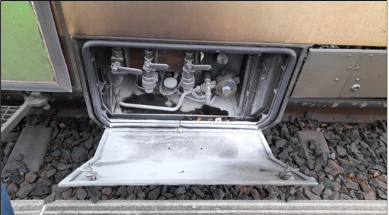
Kuva 21. Savonlinnassa 12.10.2021 palaneen yksikön 4406 huoltoluukku, jonka takana tulipalo oli. (Kuva: VR-Yhtymä Oy)
