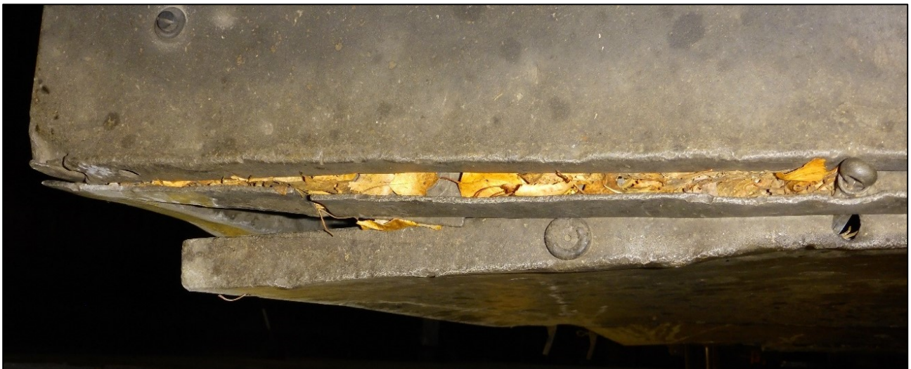
Kuva 24. Vaurioituneita suojakotelon rakenteita ja vaurioiden takia kotelon sisään päässeitä lehtiä yksikössä 4406. (Kuva: OTKES)
