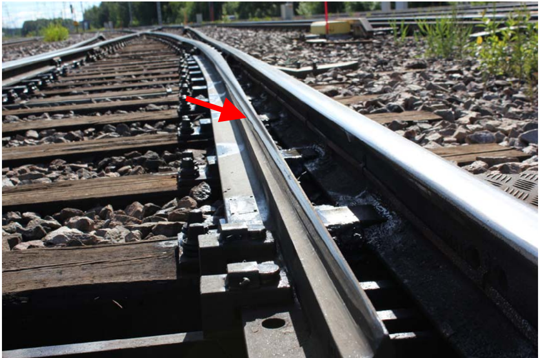
Kuva 14. Vaihteen V827 ulkokaarten puoleinen kielen kärki kuvattuna kohti junan tulo-suuntaa. Kielessä oli havaittavissa hyllykulumaa (punainen nuoli). Tukikiskossa näkyi pyörän laipan jättämä suistumisjälki heti kielen kärjen jälkeen.
