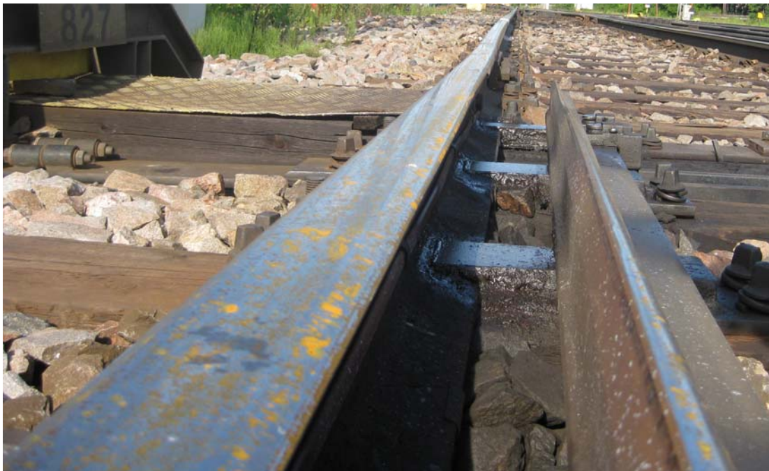
Kuva 16. Vaihteen alueella ja sen läheisyydessä kiskojen pinta oli muovautunut (tyssäntynyt) pitkän ajan kuluessa raskaan kuormituksen alla.
