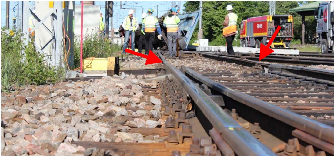
Kuva 15. Kiskoissa oli selkeästi havaittava alemmaksi painunut kohta heti vaihteen V827 kielen kärkien jälkeen (punaiset nuolet). Painuman kohdalla oli radassa myös kierousvirhettä eli ristiheittoa.
