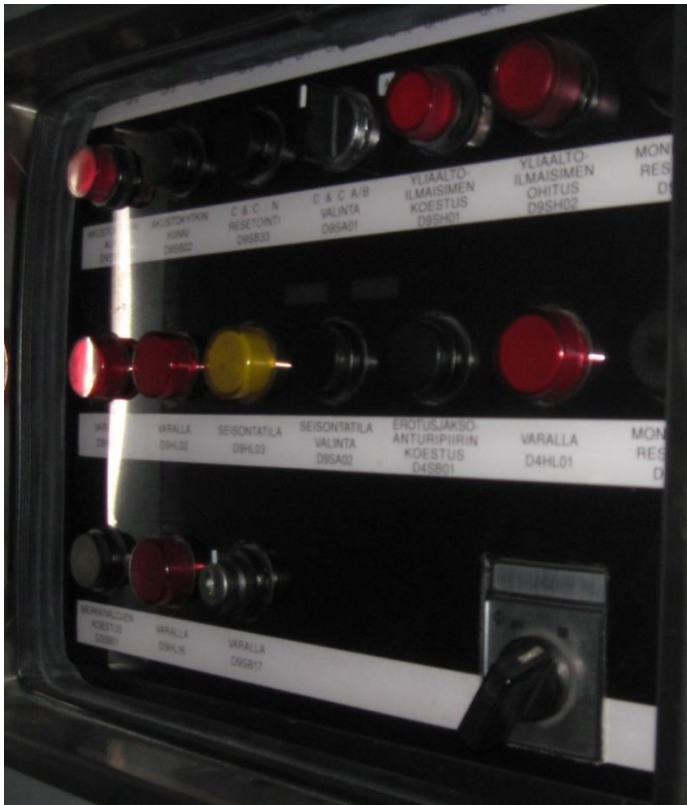
Kuva 10. JKV kytkin sijaitsee ohjaustaulussa ohjaamon oven vieressä.
