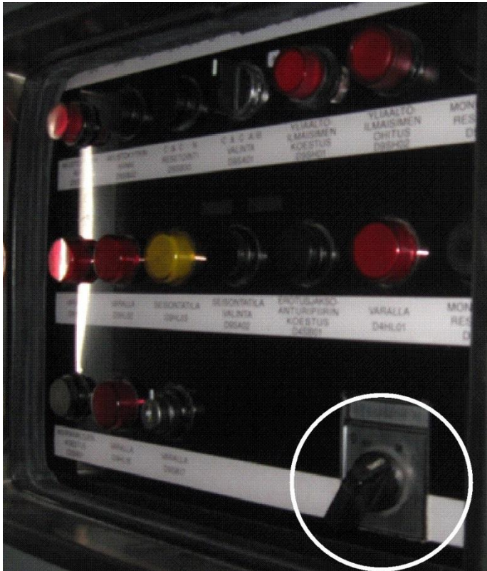
Kuva 10. JKV-kytkin sijaitsee ohjaustaulussa ohjaamon oven vieressä.
