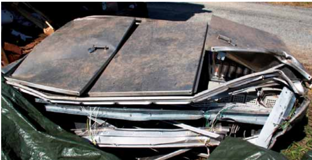
Kuva 19 Tuhoutunut turvalaitekaappi K266.
