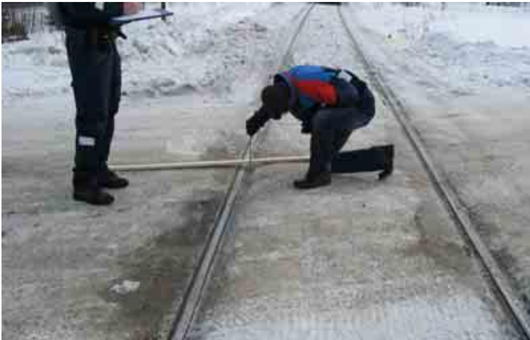
Kuva 21. Urasyvyyden mittaaminen kiskoja kohdalla. Mittauskohdan takapuolella näkyy auton vasemman eturenkaan jättämä jälki.
