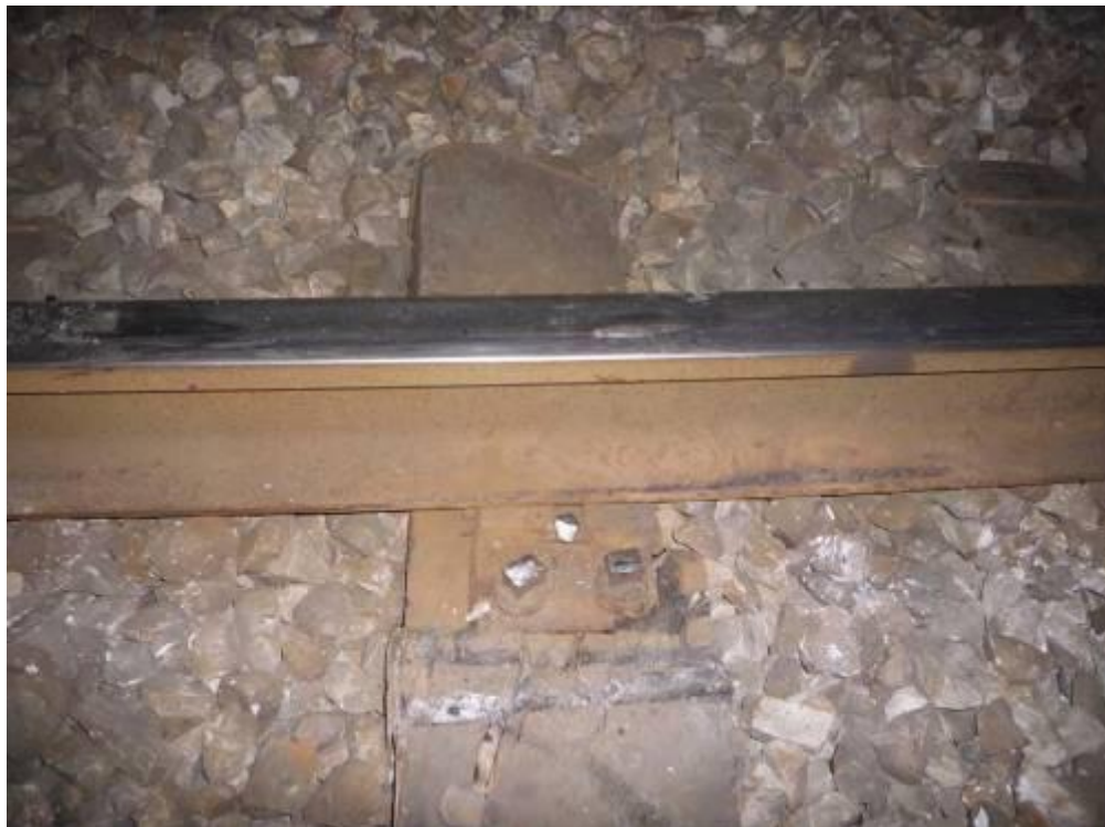
DETALLE DE DAÑOS EN LA INFRAESTRUCTURA. Fuente Renfe
