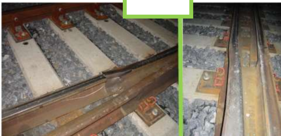
Daños en los desvíos 3 y 4
