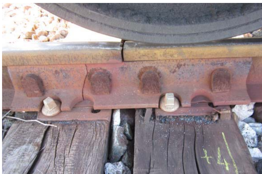
Fisura en la brida interna del hilo izquierdo en el + 4.
