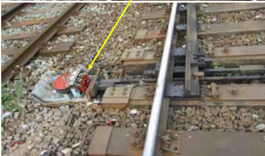
Daños en la vía (fuente: Adif)
