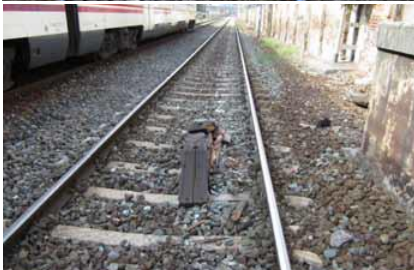
Daños en la infraestructura (fuente: Adif)
