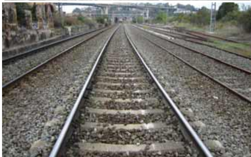
Daños en la infraestructura (fuente: Adif)
