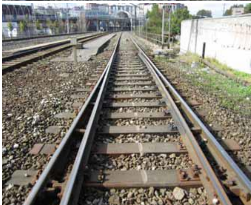
Daños en la infraestructura (fuente: Adif)
